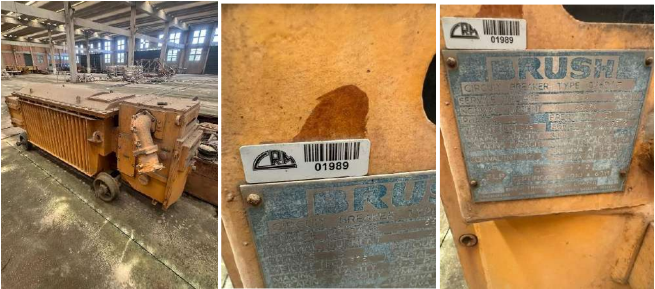
43) Um transformador alpine, patrimônio 01989
