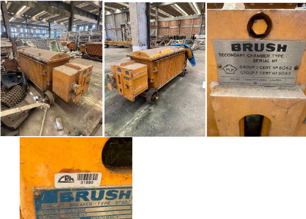
44) Dois transformadores alpine – patrimônio de um deles: 01990
